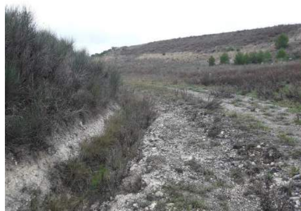
Photo 15 : Caniveau de pluvial sur plateforme +249m (28/11/19)
