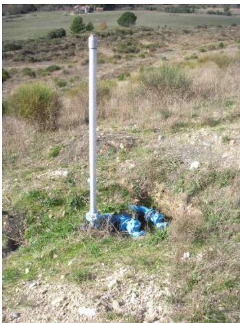
Photo 1 : Départ du drain D1 à Montredon
