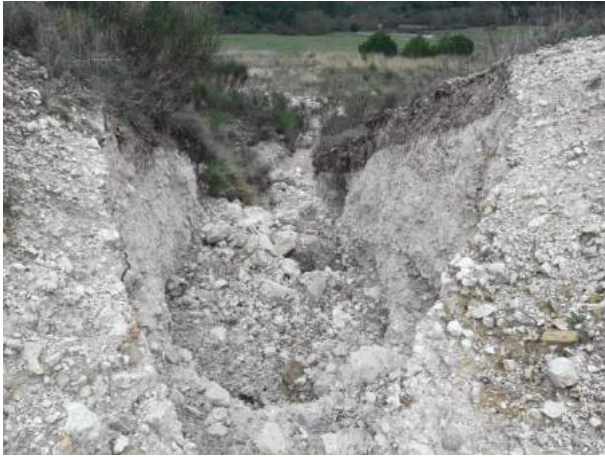
Photo 16 : Exutoire du caniveau de la plateforme +248m (18/02/19)
