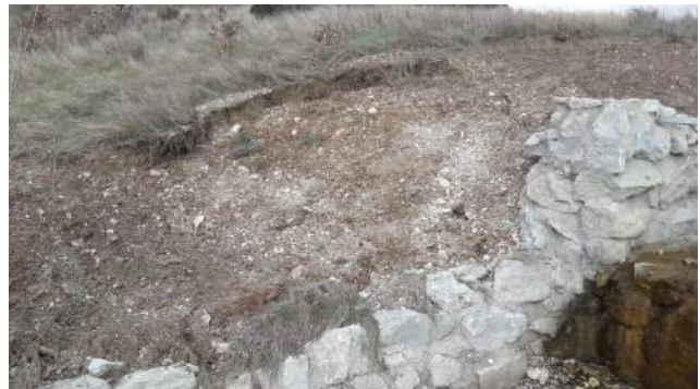
Photo 63 : Loupe de glissement à proximité du bassin de dissipation (18/02/19)
