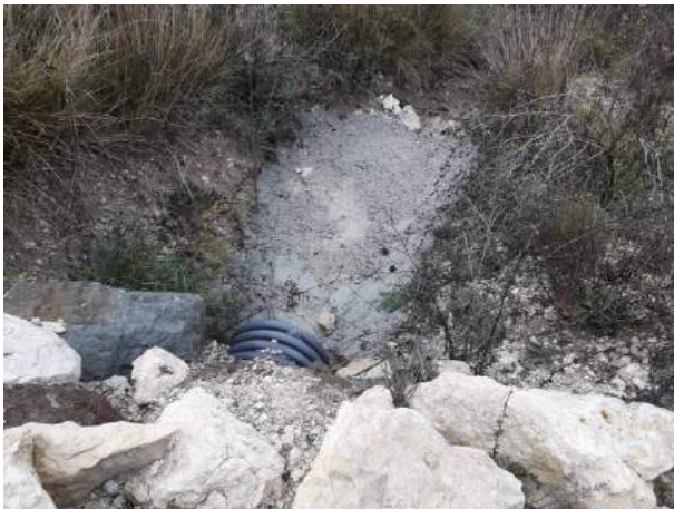
Photo 20 : Evacuation fossé longitudinal bétonné (28/11/19)
