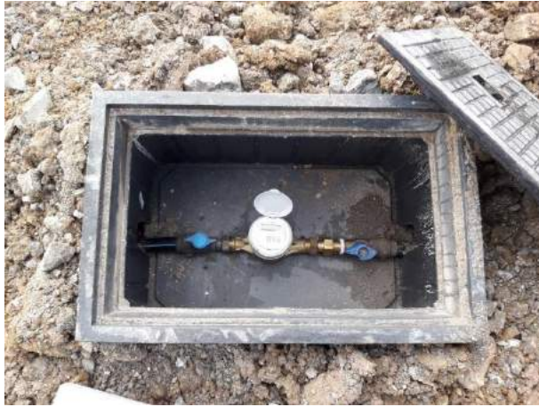
Photo 3 : Compteur du drain D1 protégé
