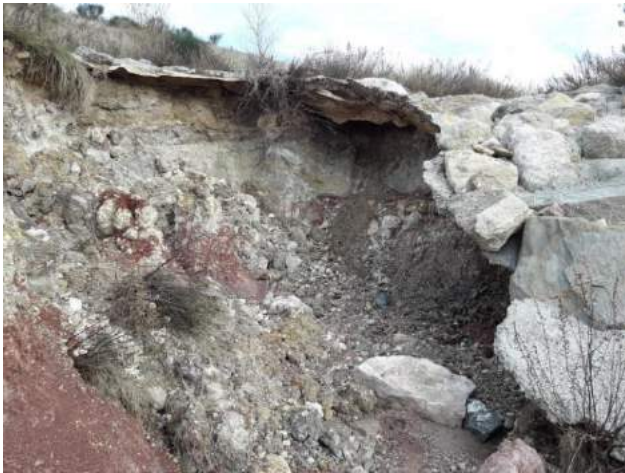
Photo 51 : Déversoir amont vers le bassin de dissipation d'énergie fortement érodé (12/12/18)
