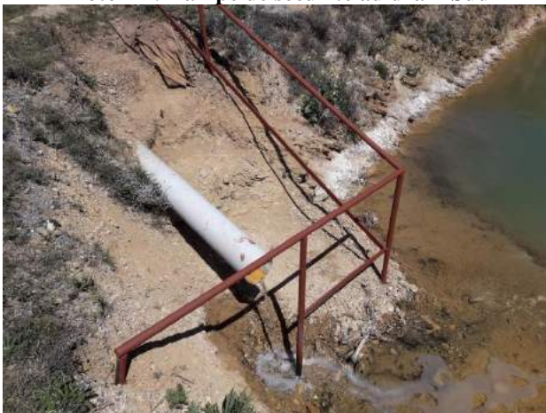
Photo 49 : Rampe de sécurité au drain Nord
