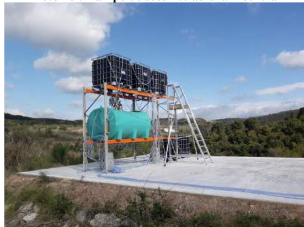
Photo 50 : Pilote de traitement des eaux à l'Artus
