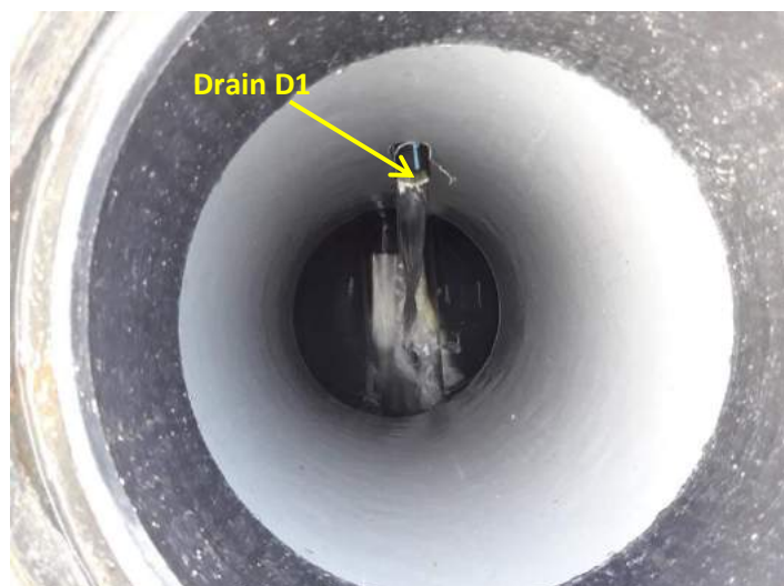
Photo 2 : Arrivée drain D1 à la station de traitement
