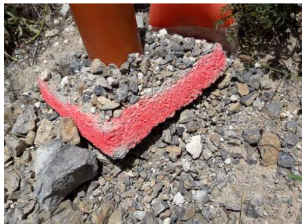
Photo 37 : Socle béton non ancré au sol
