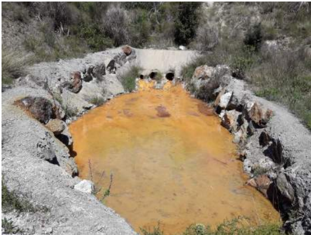
Photo 45 : Bassin de collecte des drains inférieurs (29/04/19)
