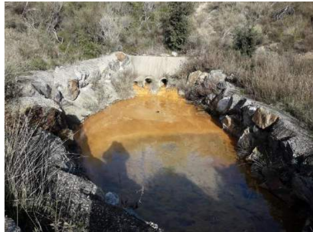
Photo 46 : Bassin de collecte des drains inférieurs (28/11/19)
